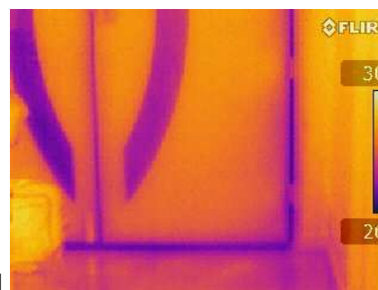
Fig (h): door leakage points
